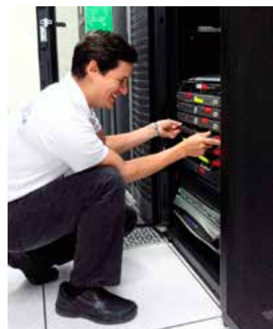
Equipos Data Center
